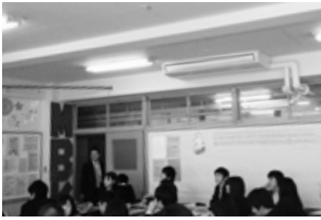
第三中学校に設置されたエアコン
