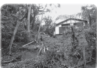
私市山手の崖崩れの状況(当時)
